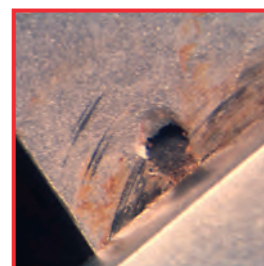
Ukázka důlkové koroze
