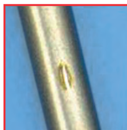
Kontaktní koroze: nerezová ocel / nerezová ocel
