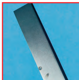
Ukázka důlkové koroze
